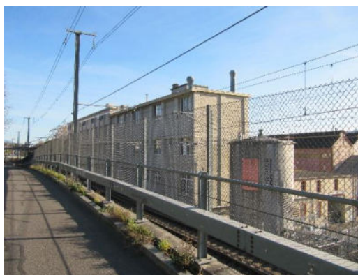
Abbildung 13: Bestand Holmgeländer Alte Landstrasse
